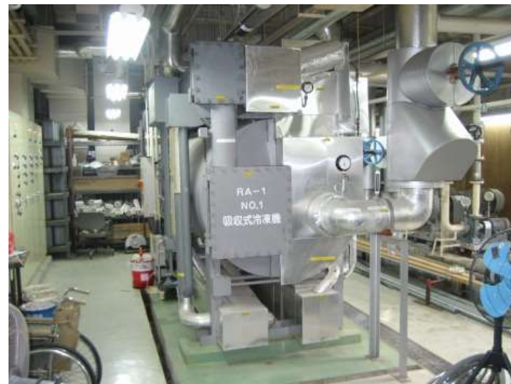
蒸気吸収式冷凍機
