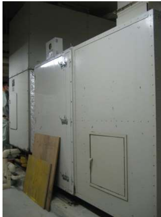
外気処理空調機
