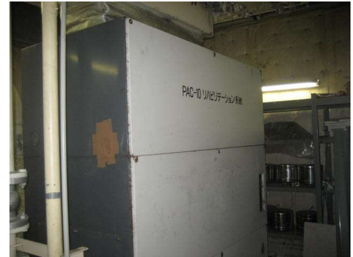
水冷パッケージエアコン
