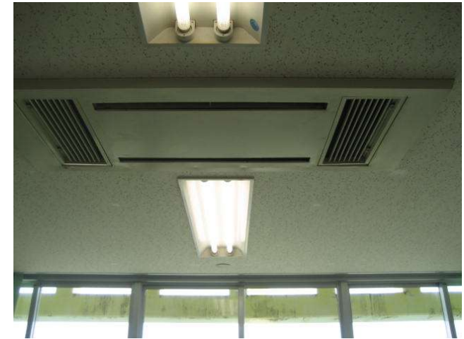
ファンコイルユニット
