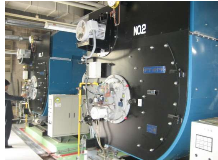
既存蒸気ボイラー
